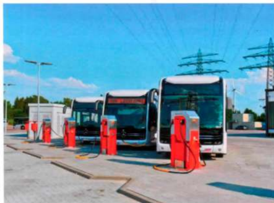
Abbildung 1: Alle Fahrzeuge müssen rechtzeitig mit der für den nächsten Umlauf geplanten Lademenge vorkonditioniert bereitstehen. Dafür sorgt das Lademanagement MOBILECharge. (Abb.: INIT | Ulrike Kabel)
